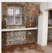
bei feuchtem Mauerwerk
