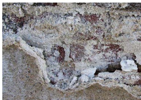
Typischer Schaden durch Salzausblühungen
